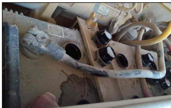
รูปที่ ๔-๑๗ การตรวจสอบระดับน้ำกรดของแบตเตอรี่
